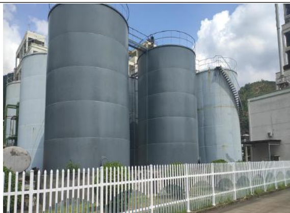
CHCl 3 和二氯甲烷储罐区
