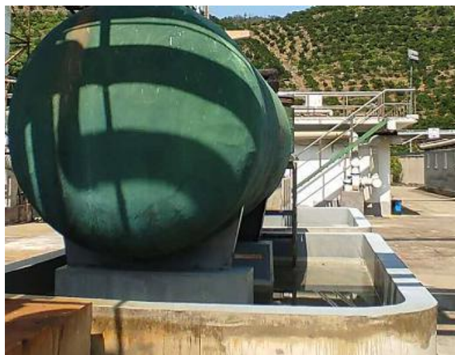
次氯酸钠储罐
