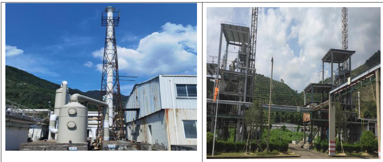
废气处理设施
